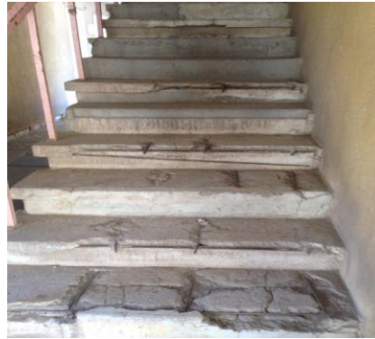
صورة رقم (3) توضح عدم فاعلية السلم وملائمته للحركة العمودية وعدم وجود مساند .
